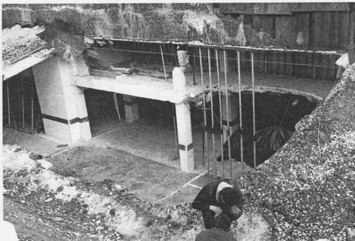
Técnicos del laboratorio de arquitectura forense analizan muestras del hormigón del garaje comunitario que se hundió en 2008 en Huarte CEIDIA
