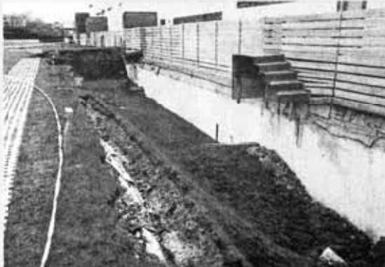
Rampa de acceso a garajes en Cizur. En 2008, un grupo de viviendas unifamiliares de Cizur vio cómo venía el techo de la rampa de acceso al garaje subterráneo por un problema de cálculo de peso de la estructura. CEDIDA
