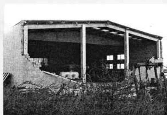
Muro caído en una nave cerca de Pamplona. El derrumbe de la pared desembocó luego en la pérdida del tejado que salió volando con el viento. El forense debe determinar si es un error de proyecto o de construcción. CEIDIA
