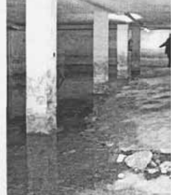
Garaje de Azagra. Al estar por debajo del nivel del río el agua se filtró desde el subsuelo levantando así el cemento.
