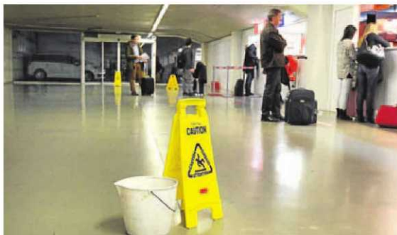
El aeropuerto ha necesitado parches por goteras y otros fallos. :: P. U.
