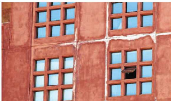
El revestimiento de estuco del hotel Meliá ha dado problemas. :: J. A.
